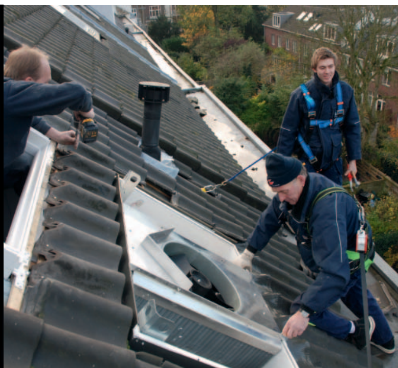
Inbouw van de Hydrotop-warmtepomp.
